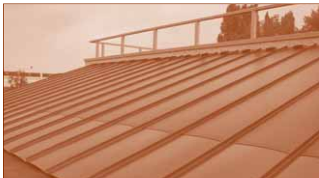
Amorfe PV-film geïntegreerd op metalen dakbanen met staande naad op onderzoekscenrum Bekaert te Zwevegem (Bekaert BESS-Europe)
