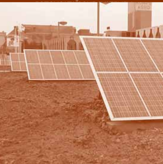
PV-systeem op begane grond in Leuven (Iverlek)
