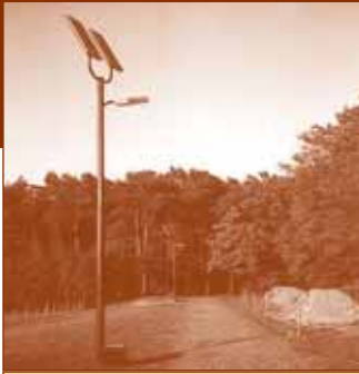
Autonome verlichtingspaal in een park te Hasselt (Solar Technics)
